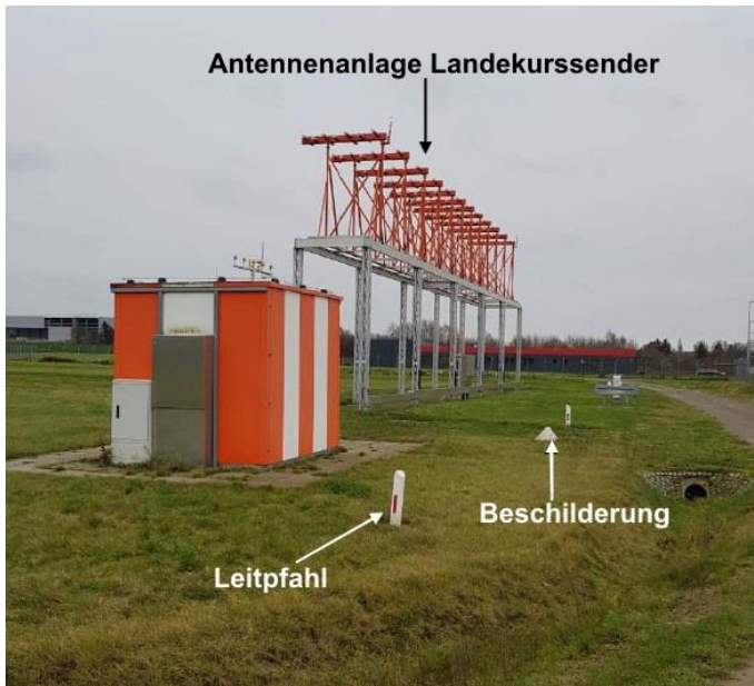
Foto des Landekursenders (LLZ) - Blickrichtung von Nord nach Süd; rechts im Bild die Rundumpiste.
